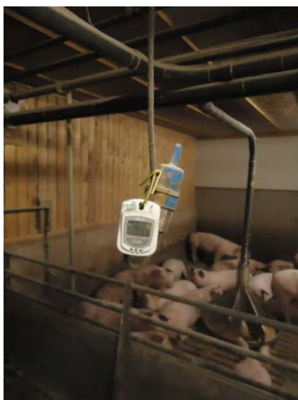
Temperaturfühler der Lüftung
